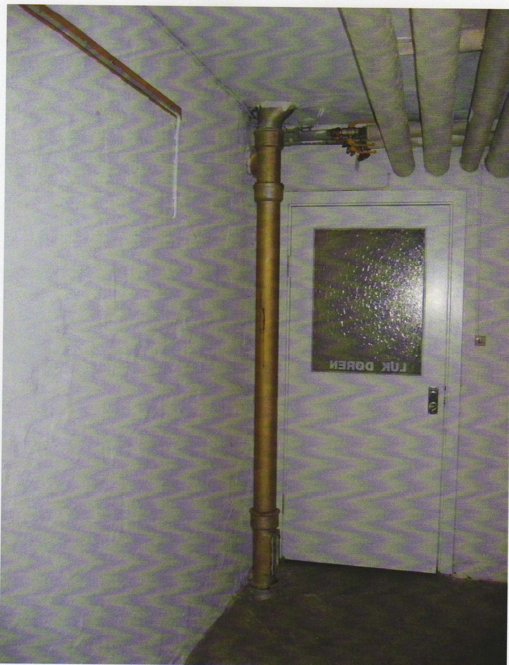
Faldstamme i kælder
